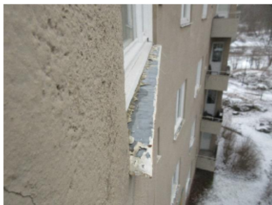
Färgen flagar på fönsterbleck
