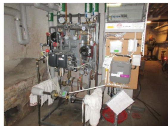
Undercentral för värme och tappvarmvatten
