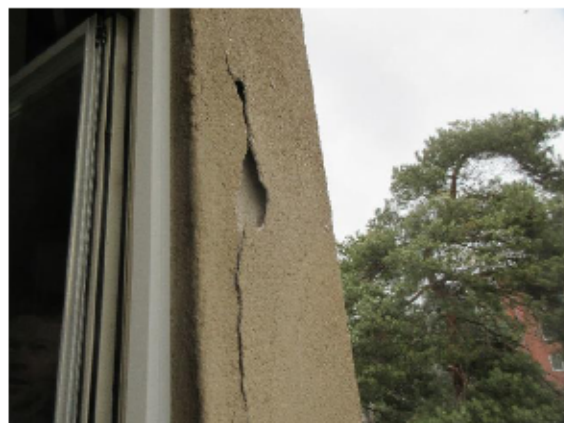
Skadad puts vid en balkong
