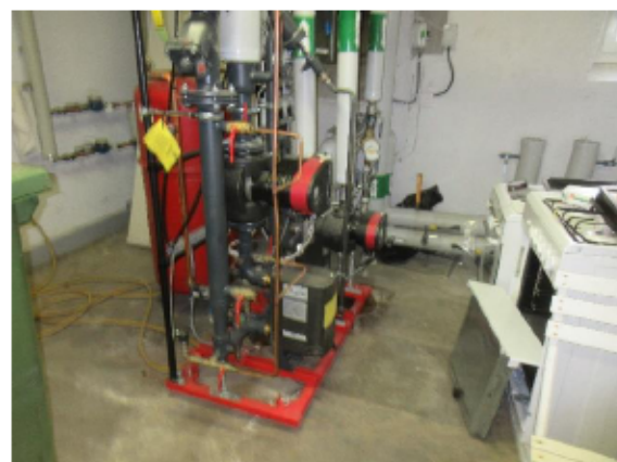
Undercentral för fjärrvärme
