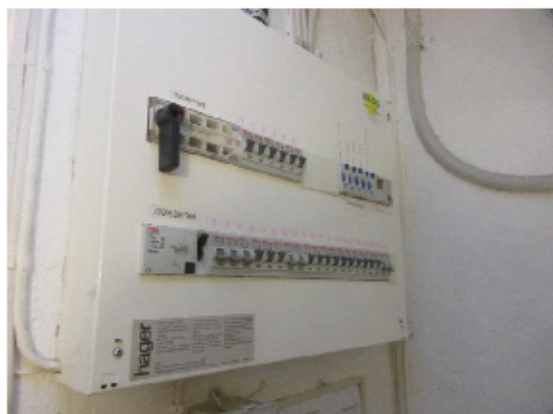
Moderniserade elektriska installationer
