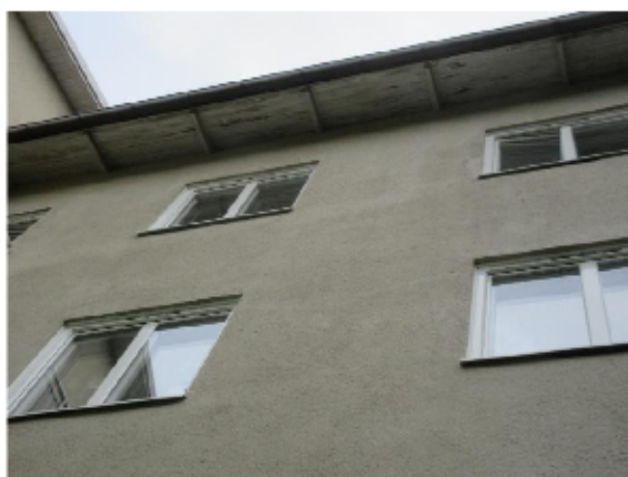
Takfot med missfärgningar
