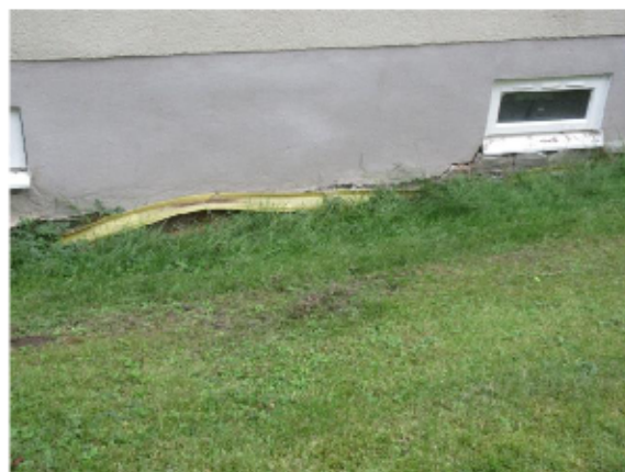
Marken lutar kraftigt mot byggnaden
