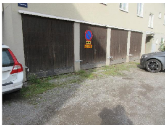
Gamla garagedörrar med eftersatt underhåll
